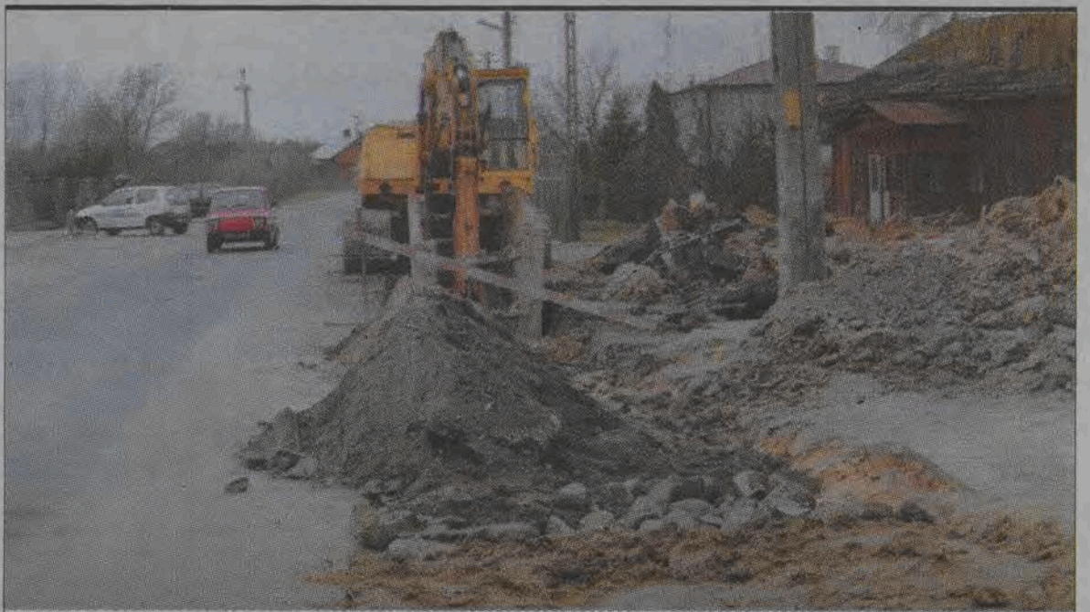
Takie obrazki na ulicach Bolimowa nie są rzadkością, odkąd rozpoczęto budowę kanalizacji, stają się coraz częstsze. Rozkopy, zwały ziemi, doły znacznie utrudniają poruszanie się po okolicy. Wójt gminy Bolimów Andrzej Jagura zapowiada, że wkrótce sytuacja ulegnie radykalnej poprawie. Firma zajmująca się budową ma wyrównać teren i naprawić chodniki, a w przypadku prowadzenia dalszych prac wszelkie zmiany w nawierzchni będą naprawiane na bieżąco. (aj)
