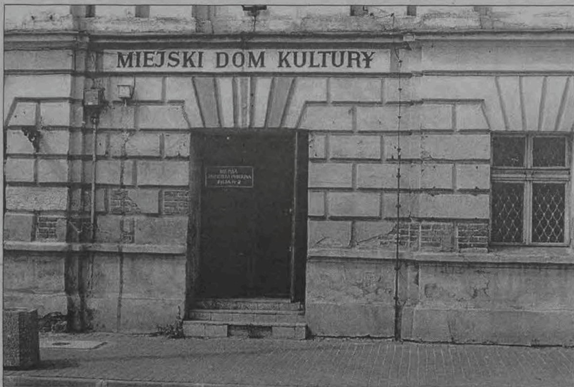
Budynek MDK przy ul. Podrzecznej nadaje się wyłącznie do generalnego remontu
