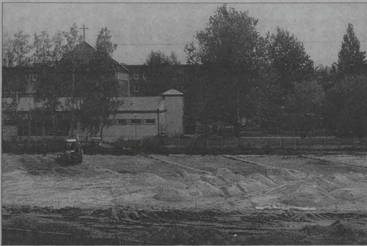
Boisko powstaje na terenie między budynkiem Kolegium Teologicznego, nasypem wiaduktu nad torami kolejowymi a ul. Seminaryjną
