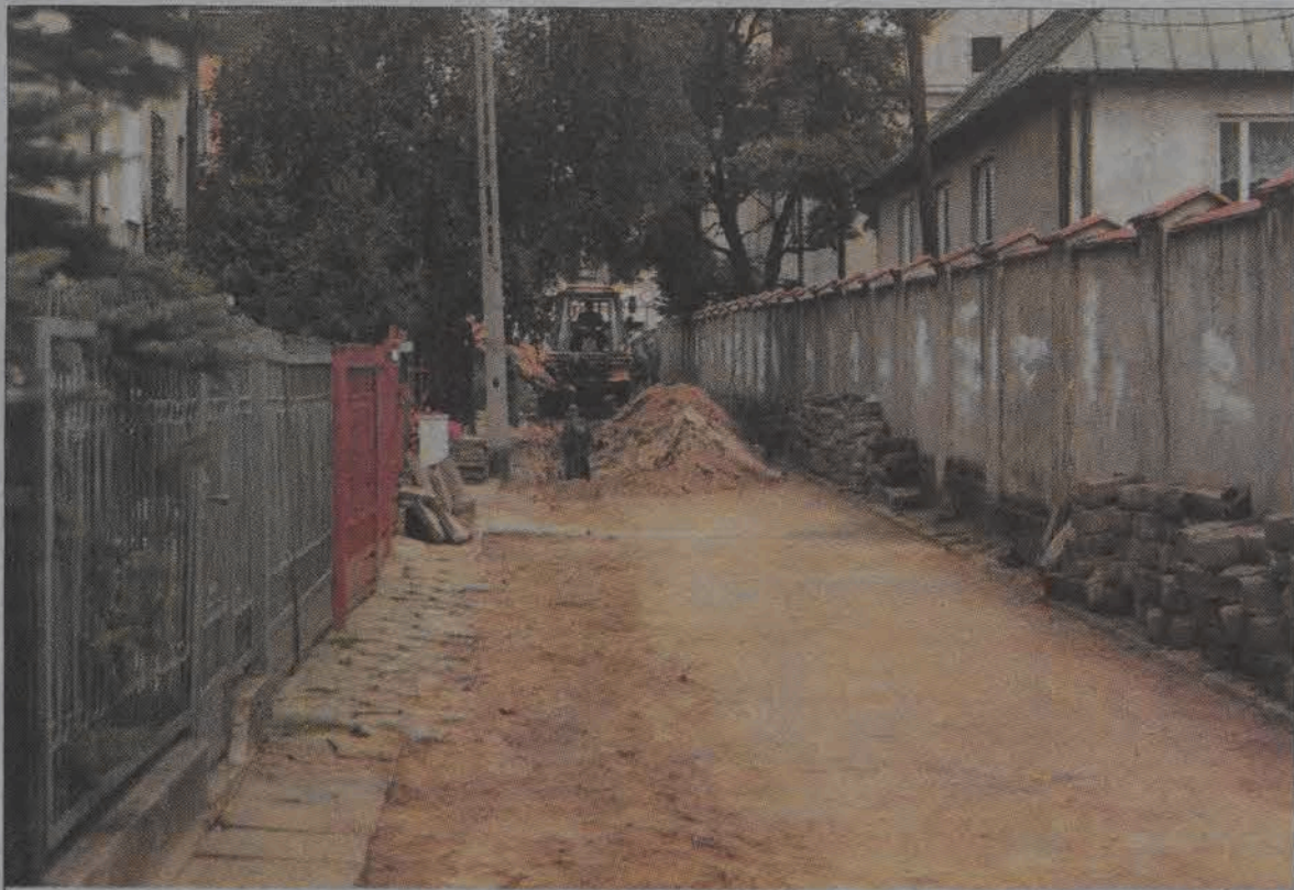
Wodociąg na Chopina. Pracownicy Oddziału Wodociągów i Kanalizacji łowickiego Zakładu Usług Komunalnych w ubiegłym tygodniu wykonywali nową sieć wodociągu i przyłącza do poszczególnych posesji w ulicy Chopina w Łowiczu. Podczas prowadzonych robót ta wąska ulica była całkowicie nieprzejezdna. Dlatego też wodociągowcy mieli za zadanie jak najszybsze uporanie się z remontem. Niejako przy okazji wyrównana została nawierzchnia na tej ulicy.
