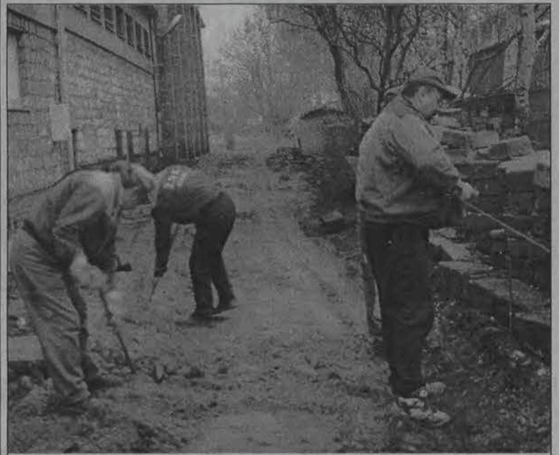
Tak wyglądały w ubiegłym tygodniu prace przy remoncie wjazdu i parkingu przy LO im. Chełmońskiego.
