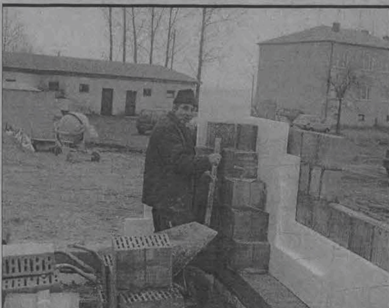
Zarząd gminy Chańsko wizytował budowę szkoły. W środę, 10 stycznia Zarząd Gminy Chańsko wraz z wójtem Romanem Łazińskim i dyrektorem Zespołu Szkół Publicznych w Błędowie wizytował rozbudowę szkoły dla potrzeb gminnego gimnazjum. Radni wyrazili zadowolenie z postępujących prac. Powstające mury są wysokie już na dwa metry. Jeżeli prace będą posuwać się w takim tempie, zostaną ukończone przed 1 września. Prace wykonywane są przez firmę Eko - Piec z Łowicza. (aw)
