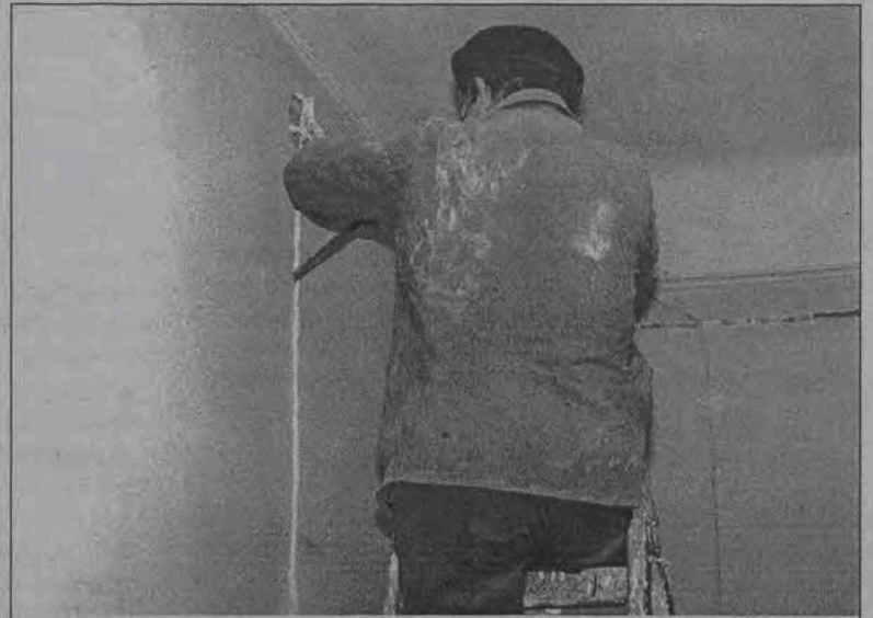
Remont w siedzibie PCK. Od minionego tygodnia trwa remont w siedzibie Zarządu Okręgowego PCK w Łowiczu przy ulicy Nowy Rynek 5. Prace związane są z przeniesieniem siedziby punktu krwiodawstwa ze szpitala do PCK. Teraz punkt mieścił się będzie w pierwszym pomieszczeniu po wejściu do siedziby Polskiego Czerwonego Krzyża. Montowana jest instalacja wodno-kanalizacyjna. Przeniesione zostały wszystkie rzeczy ze szpitala. Punkt będzie czynny najprawdopodobniej od 15 lutego. (aw)
