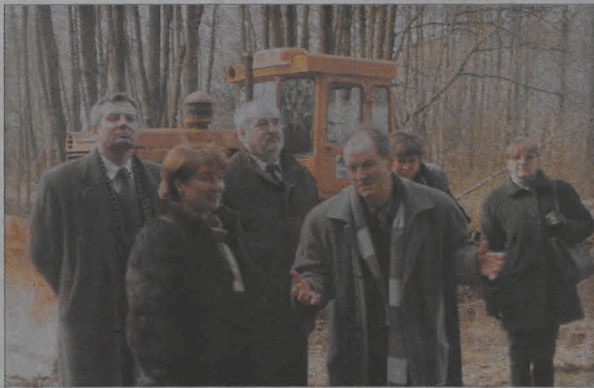
Na pierwszym planie Marszałek Krystyna Ozga oraz dyrektor WZM i UW Bogumił Kazulak na placu rozpoczętej budowy zbiornika w Ziemiarach.
