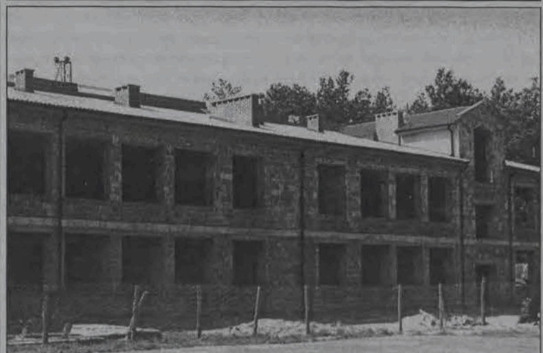
Prace przy rozbudowie gimnazjum w Dzierzgowku posuwają się zgodnie z planem i wszystko wskazuje na to, że od września placówka przybędzie cztery sale lekcyjne (po dwie na każdej kondygnacji). Zaspokoi to przyszłoroczne potrzeby lokalowe placówki, która od września powiększy się o trzy oddziały. W dalszej kolejności na górnej kondygnacji oddane zostaną jeszcze trzy pomieszczenia lekcyjne oraz łazienki. Obszerna pracownia audiowizualna, wykorzystywana będzie również jako czytelnia, sala prelekcyjna, ponadto będzie tam również pracownia informatyczna i sala lekcyjna. Na dolnej kondygnacji powstanie pełne zaplecze sali gimnastycznej no i oczywiście sala gimnastyczna.
