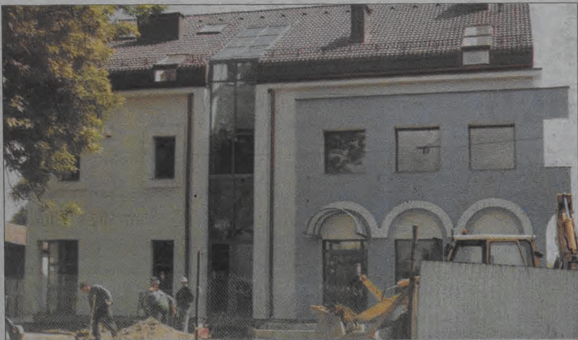
Trwają już ostatnie prace wykończeniowe przy nowo wybudowanym gmachu Zakładu Energetycznego w Łowiczu. W umowie wykonawca budynku zobowiązał się do ukończenia prac do końca lipca. Ze względu jednak na to, że obecnie trwają również prace przy budowie dróg wewnętrznych na terenie zakładu, termin oddania całości może opóźnić się o kilka tygodni. Petenci zakładu będą jednymi z pierwszych osób, które odwiedzą nowy gmach, wszak na parterze będzie się mieścić nowoczesna sala obsługi klientów. Tonację biało-niebieską przybierze również sąsiedni, stary budynek. (ljs)
