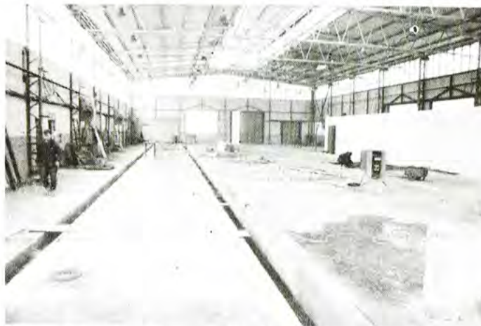
Trwają już prace przy adaptacji jednej z dwu POM-owskich hal na potrzeby nowego właściciela.
