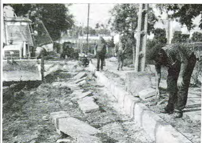
Powoli, ale jednak zbliżają się do końca prace przy układaniu nawierzchni ul. Jagiellońskiej w Łowiczu. Ta mała, willowa uliczka położona w trójkącie między torem kolejowym, Bzurą a ulicą Warszawską była dotąd w deszczowe dni jedną z najbardziej zabłoconych w Łowiczu. Na zdjęciu: ekipa Zakładu Usług Komunalnych przy zakładaniu krawężnika.
