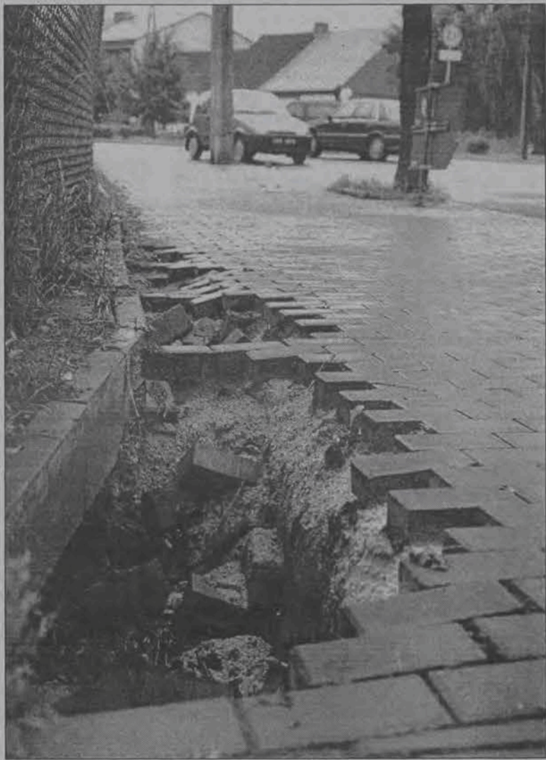
Ulewy wymyły grunt spod chodnika na ul. Świętojańskiej, zarwały go i utworzyły dziurę głęboką na ponad pół metra. Stanowi ona od kilkunastu dni zagrożenie dla przechodniów, których nie brakuje na tej ulicy. Zabić się tu trudno, ale połamać nogę można na pewno. (tb)
