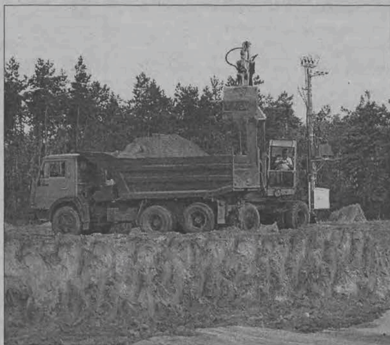
Na terenie złoża Kalenice II trwają obecnie prace przy przygotowywaniu pokładu do eksploatacji.
