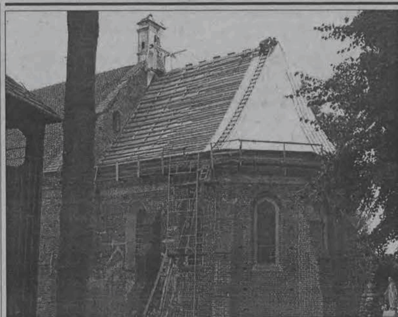
MIEDZIANY DACH NA KOŚCIELE. Od kilku tygodni trwa remont dachu na kościele Najświętszej Maryi Panny w Bielawach. W tym roku zaplanowano założenie miedzianego dachu nad prezbiterium, w przyszłym natomiast - na pozostałej jego części. Remont w znacznej części finansowany jest za pieniądze zebrane od parafian, ale nie tylko. Kościół otrzymał dofinansowanie w wysokości 10 tys. zł z funduszu kościelnego MSWiA. Cel jest tym bardziej szczytny, że nie chodzi tylko o zabezpieczenie kościoła, ale również o godne przygotowanie go do obchodów 600-lecia, które przypada na rok 2003. (ljs)
