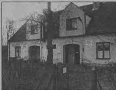
Budynek ośrodka zdrowia potrzebuje gruntownego remontu. Kto go wykona?
