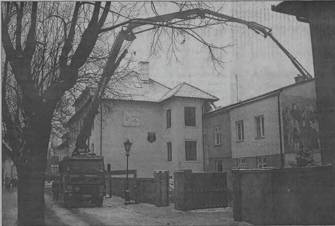
Na odległość do 36 metrów może podawać beton, gigantyczny, zamontowany na podwoziu Volvo podajnik Pützmeister, własność firmy Mirbud, który w miniony poniedziałek, 10 grudnia łowiczanie mogli zobaczyć na ulicy Pijarskiej. Został on wykorzystany do zalania stropu nad dotychczasowym małym wirydarzem w rozbudowywanym pod potrzeby liceum zespole szkół pijarskich, do którego to miejsca z żadnej strony nie ma możliwości dojazdu.
