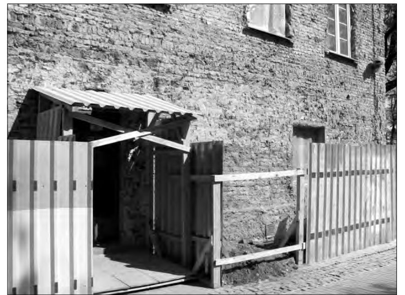
Tynki z budynku zostały całkowicie usunięte. Nad wejściem widać fragmenty rudy darniowej.
