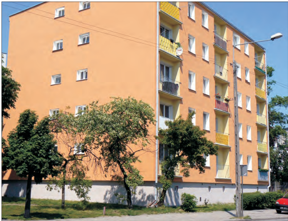
Bloki może i wyglądają po dociepleniu jak nowe, ale zostały zbudowane wiele lat temu.
