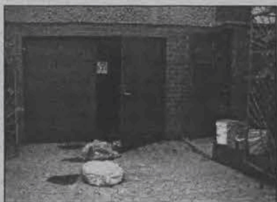
Podczas obfitych opadów piwnica w domu Henryka K. jest zalewana wodą dostającymi się z odpływów ściekami.
