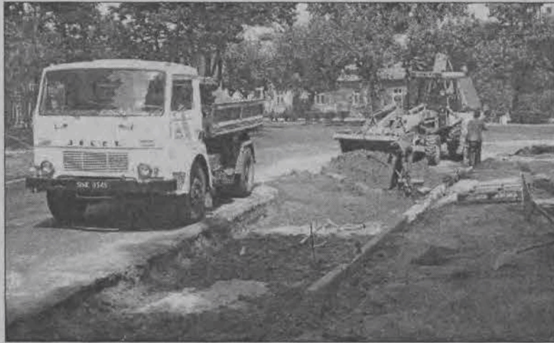
W ubiegłym tygodniu PRID rozpoczął prace przy prawoskręcie z ul. Kaliskiej w 1 Maja, prace na terenie całego Końskiego Targu zakończą się pod koniec sierpnia.
