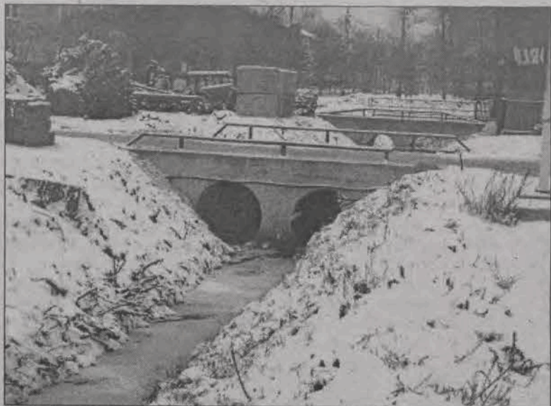
Ku końcowi zbliżają się prace przy renowacji kanału Kostka w Łowiczu. Na początku tego roku firma Melkan z Łowicza, która wygrała przetarg na te roboty, przebudowała przepust w ulicy Katarzynie. Wiosną zaplanowane są natomiast prace agrotechniczne przy kanale, czyli wymiana części darni, dosianie trawy i zabezpieczenie brzegów przed zarywaniem się. (mak)
