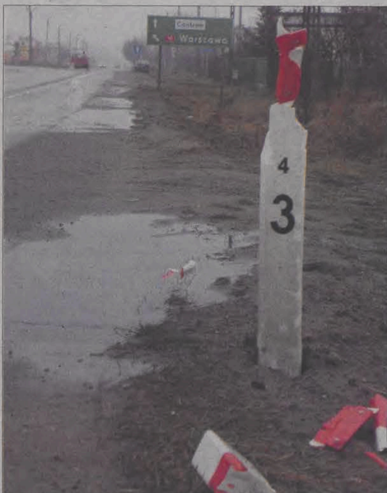
Zniszczonych pachołków na odcinku drogi krajowej nr 14 pomiędzy Łowiczem a Krępą jest ponad 100. Fot. Zarząd Dróg Krajowych.
