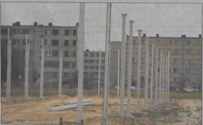
Pierwsze prace przy stawianiu Centrum Handlowego „Tuszewska” na Bratkowicach, łowicki inwestor Dariusz Karski rozpoczął w sierpniu. Dziś pawilon ma już ściany, posadzkę i dach, oddany do użytku zostanie wiosną.
