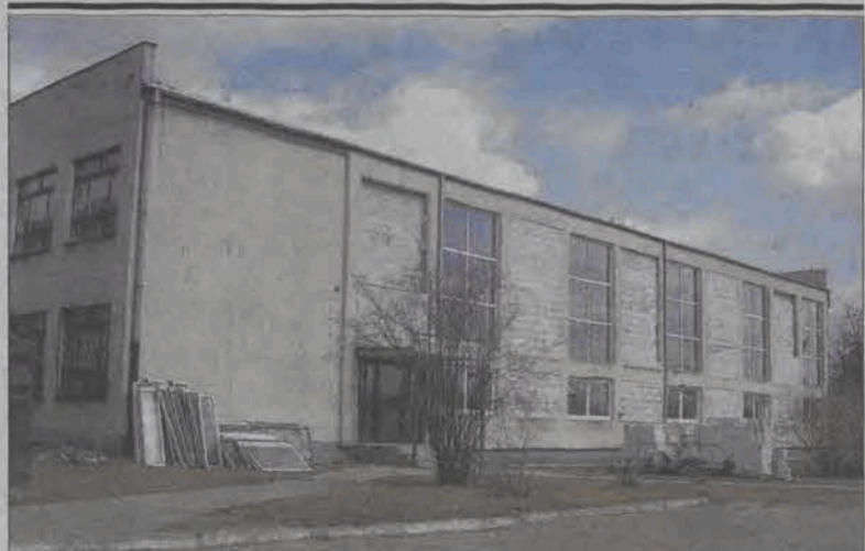
W budynku sali gimnastycznej, internatu i w budynku głównym szkoły na Blichu wymieniono ostatnio 102 okna. Ich powierzchnię na sali gimnastycznej zmniejszono o 2/3. Prace, prowadzone od kilku tygodni przez przedsiębiorstwo Józefa Muchy z Kutna, skoncentrują się teraz na sali gimnastycznej i obejmować będą wymianę oświetlenia z jarzeniowego na sodowe, a po zakończonych maturach także malowanie ścian, cyklizowanie i malowanie parkietu. 300 tys. zł na remont pochodzi po połowie z budżetu powiatu i WFOŚiGW w Łodzi. (tb)
