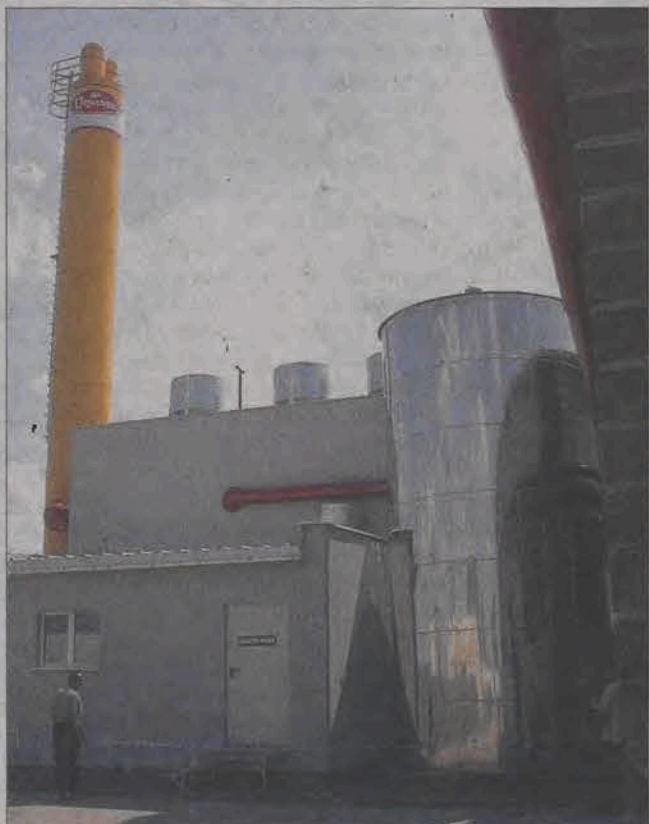
Nowo powstała kotłownia w firmie Bracia Urbanek powstała również przy udziale środków SAPARD.
