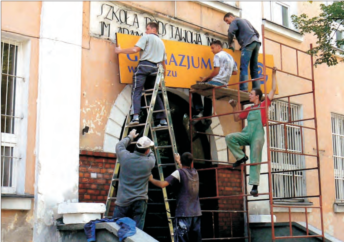
Termomodernizacja „Dwójki”. Docieplenie Szkoły Podstawowej nr 2 oraz Gimnazjum nr 2 prowadzi firma Andrzeja Malczyka z Łowicza, która 25 czerwca wygrała przetarg, proponując kwotę 1.088.796 zł. W ubiegłym tygodniu zdjęwane były szyldy z nazwami placówek, aby można było swobodnie docieplić budynek metodą „lekką-mokrą”, na którą położony zostanie tynk akrylowy na pow. 2108 mkw. Docieplony zostanie dach, wymienionych 32 okna i 8 drzwi. W Szkole Podstawowej nr 2 oraz Gimnazjum nr 2 likwidowana jest ponadto kotłownia węglowa, szkoła zostanie podłączona do miejskiej sieci ciepłowniczej. Prace te przeprowadzi firma Cewokan z Łowicza za kwotę 1.473 tys. zł.
