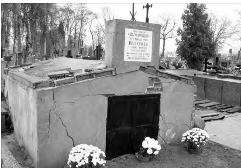
Grob Romualda Oczykowskiego to jeden z tych, które natychmiast wymagają remontu.
