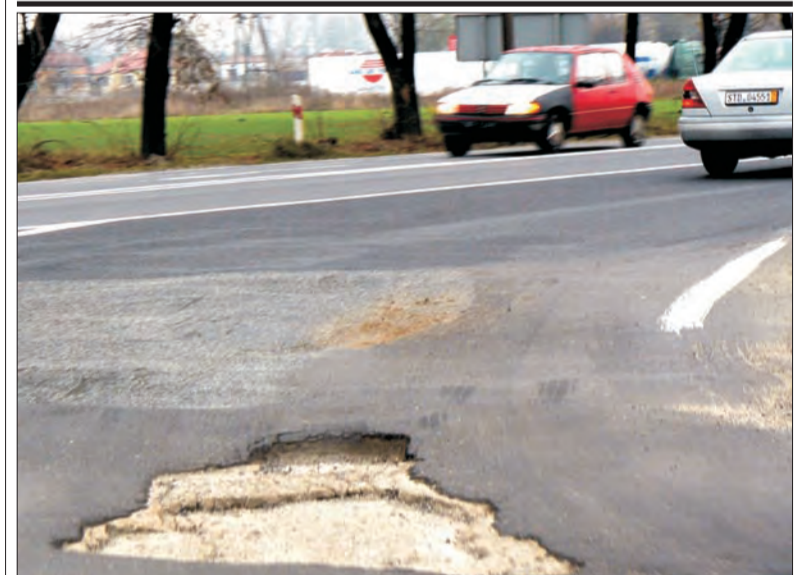
Taka dziura czeka na kierowców skręcających w prawo z drogi krajowej numer 14 na drogę krajową numer 2 w Łowiczu - w stronę Warszawy. Asfalt jest poważnie uszkodzony na powierzchni około 2 m². Naprawy należy spodziewać się do końca roku - bo tym razem nie będzie to łatanie, lecz gruntowna przebudowa całego skrzyżowania.
