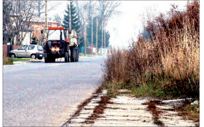
Ulica Chełmońskiego: asfalt jest, chodnik był, na kanalizację ciągle się czeka.
