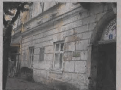
Remont elewacji i wymiana okien na pewno się przyda budynek nie wygląda bowiem od frontu zbyt okazale.
