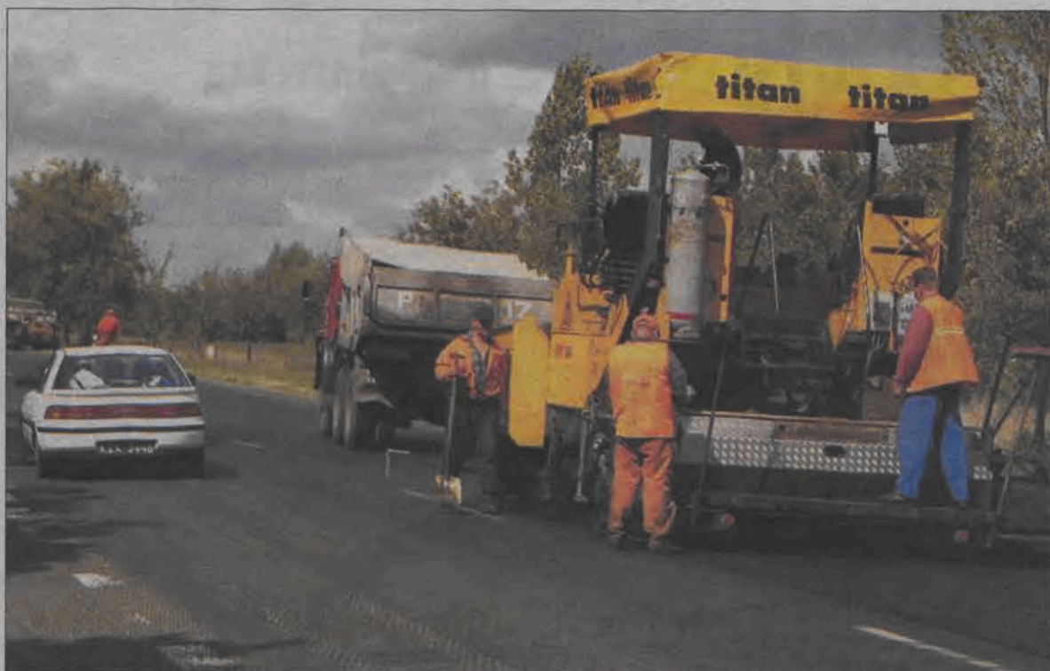
Prace na trasie Warszawa - Poznań prowadzone są po jednej stronie drogi. W tym czasie ruch odbywa się wahadłowo.
