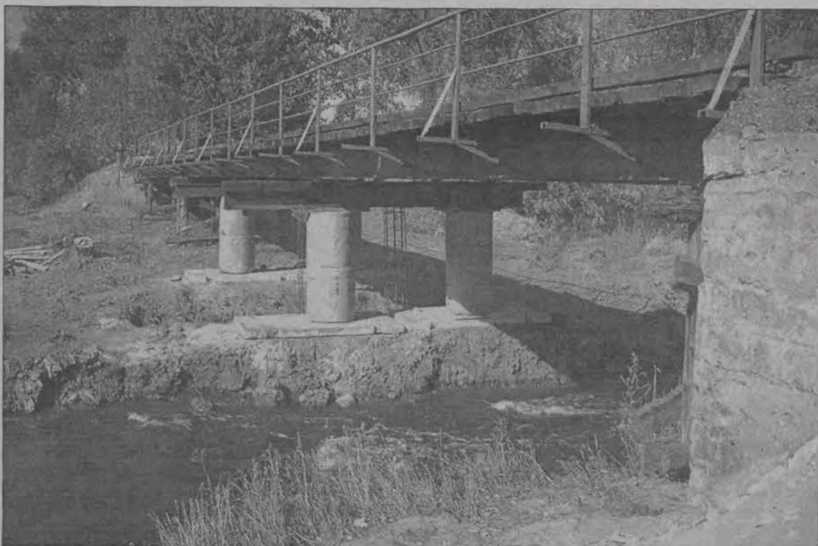
Betonowe podpory podtrzymują nawierzchnię mostu, to osłabienie konstrukcyjne wyklucza przejazd po nim z jednego brzegu Bzury na drugi.
