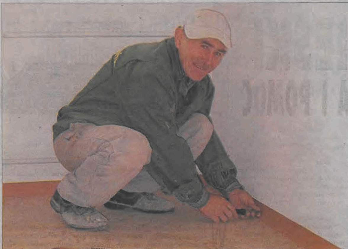
To już ostatnie prace wykończeniowe w bloku na Armii Krajowej - montowanie listew przypodłogowych.
