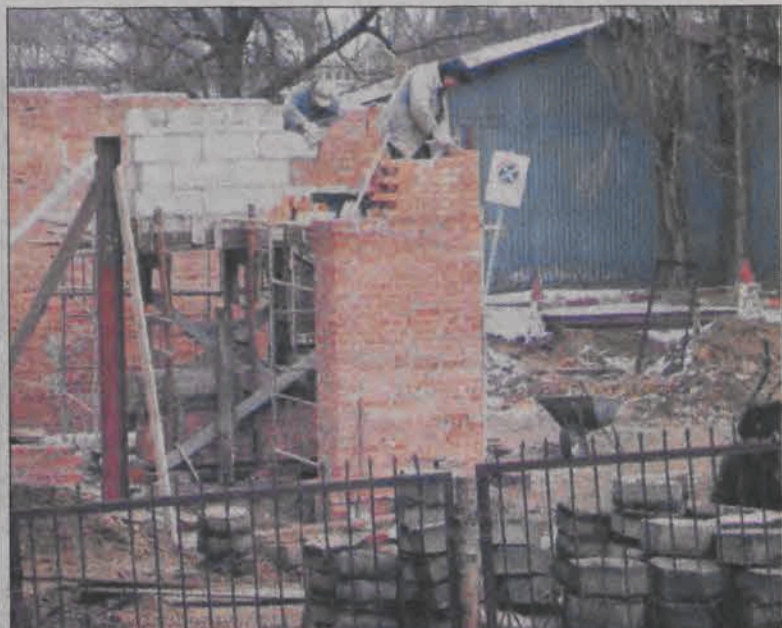
Nadal trwają prace w łowickim szpitalu przy modernizacji izby przyjęć i przy dobudowie drugiego, niezależnego wejścia do szpitala od strony rentgena. W chwili obecnej zakończono już prace w sali restytucyjnej, kontynuowany jest remont holu przyjęć. Wykonawcą modernizacji izby przyjęć jest firma Wiesława Łona z Kiernozi, nowe wejście do szpitala wykonuje natomiast łowicka firma PBH. Zakończenia wszystkich prac można się spodziewać pod koniec kwietnia. (mwk)
