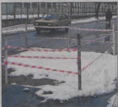
Zapadający się asfalt na ulicy Sikorskiego został ogrodzony, a oprócz tego obowiązuje ograniczenie prędkości ruchu pojazdów do 30 km/h.
