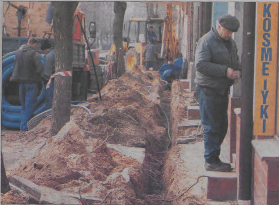
W chwili układania kabla wzdłuż Al. Sienkiewicza dostęp do sklepów był utrudniony.
