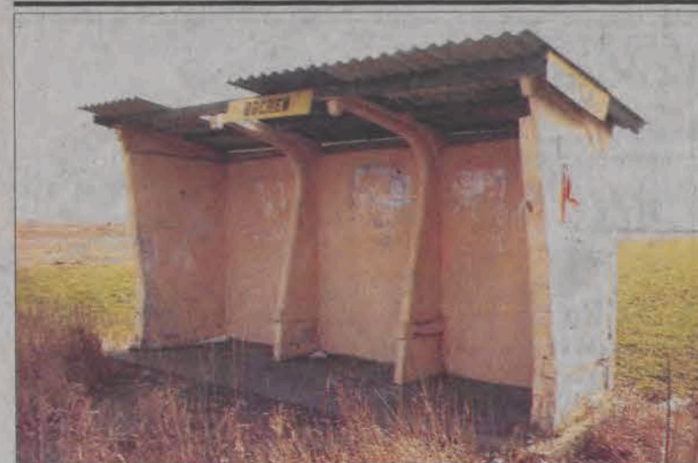
Na trasie Chruslin - Łowicz stoi kilka przystanków autobusowych, a każdy z nich jest tak samo zaniedbany i zdewastowany. Obdrapane i oszpecone sprayem tynki, skrawki nieusuniętych plakatów nie tworzą miłego otoczenia, w którym trzeba czekać na autobus, czasem nawet kilkanaście minut. To jednak zastuga ludzi, którzy niekiedy sami z tych przystanków przecież korzystają. (mk)
