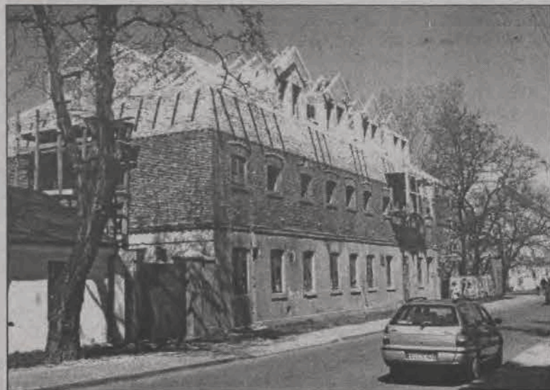
Budynek przy ul. Tkaczew powoli zmienia się w kamienicę.
