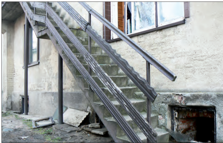
Poczerniały otwór piwnicznego okna świadczy o tragedii dwojga ludzi, jaka rozegrała się w domu w Kiernozi.
