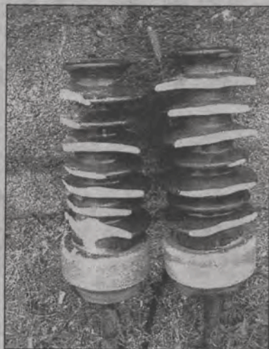
Tak wyglądają izolatory zdjęte ze słupa w Klewkwie. Popękały one od sił towarzyszących łukowi elektrycznemu, jaki powstał w czasie spiecia, które wywołała zawieszona na nich mokra słoma.
