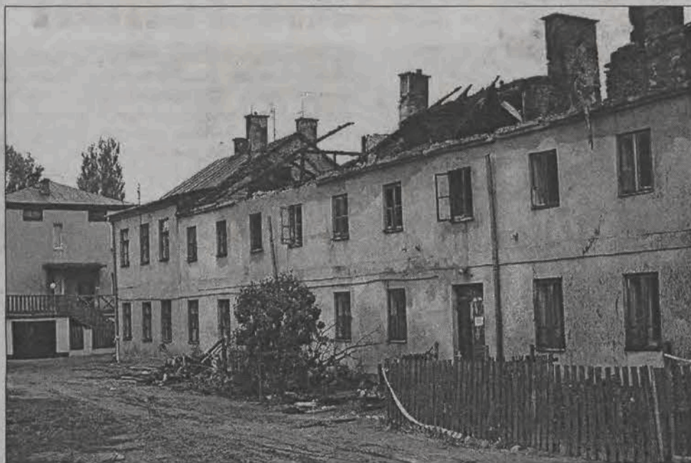
Tak wygląda obecnie spalony budynek przy ul. Fabrycznej 2. Spalony jest strych, dach, klatka schodowa, a cały budynek nasiąknięty wodą.
