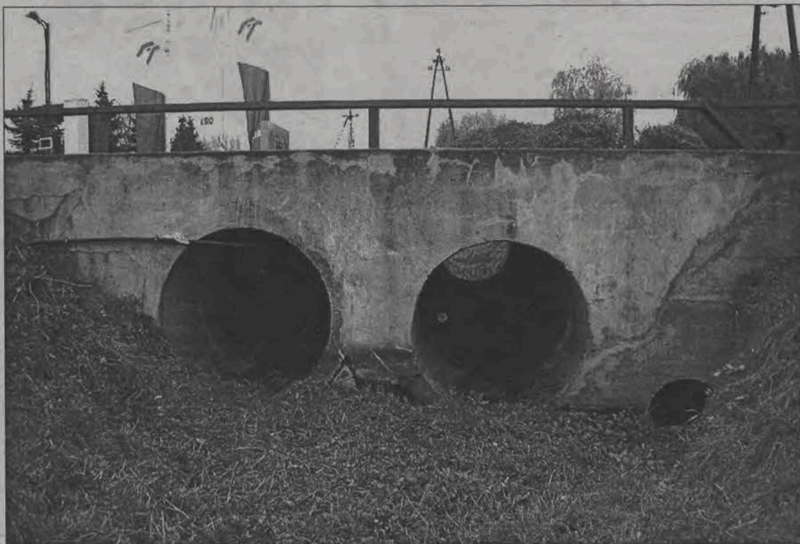
Symptomy suszy glebowej widać nawet w mieście. W widocznym na zdjęciu odcinku kanału Malinówka na Katarzynowie woda od jakiegoś czasu już nie płynie, choć jego dno nie jest jeszcze zupełnie suche.
