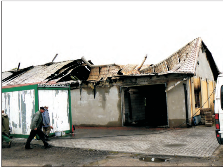
Zgłoszcza zostały po pożarze budynku usługowego przy trasie nr 2 w Popowie. Nie wiadomo jeszcze, czy konstrukcja będzie musiała być zburzona, czy zostanie wykorzystana przy odbudowie.
