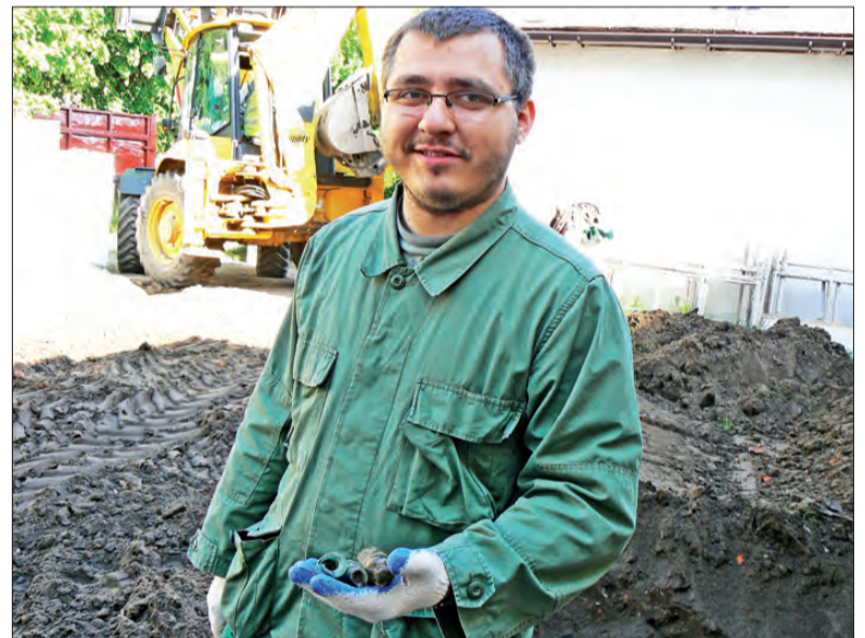
Archeolog Artur Ginter prezentuje tylko część znalezionych buteleczek. W tle, jak widać, trwają prace przy kopaniu fundamentów.
