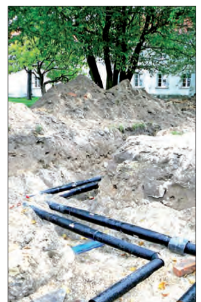
Do szkoły doprowadzona jest już sieć zasilająca w ciepło.
