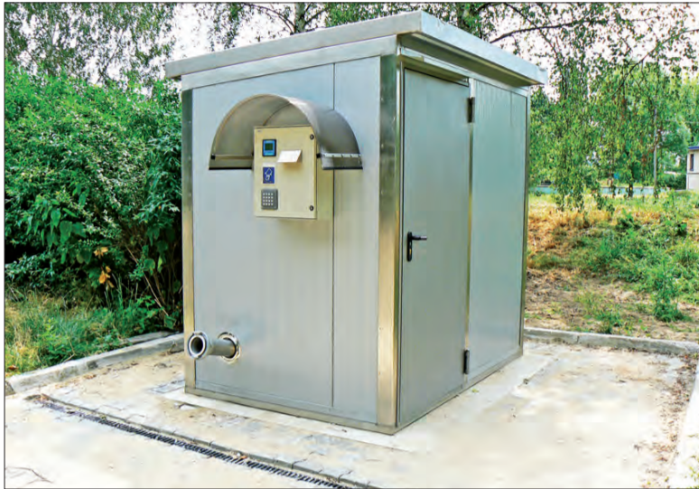
Niepozorna, blaszana budka na miejskiej oczyszczalni to nowoczesna zlewnia ścieków.
