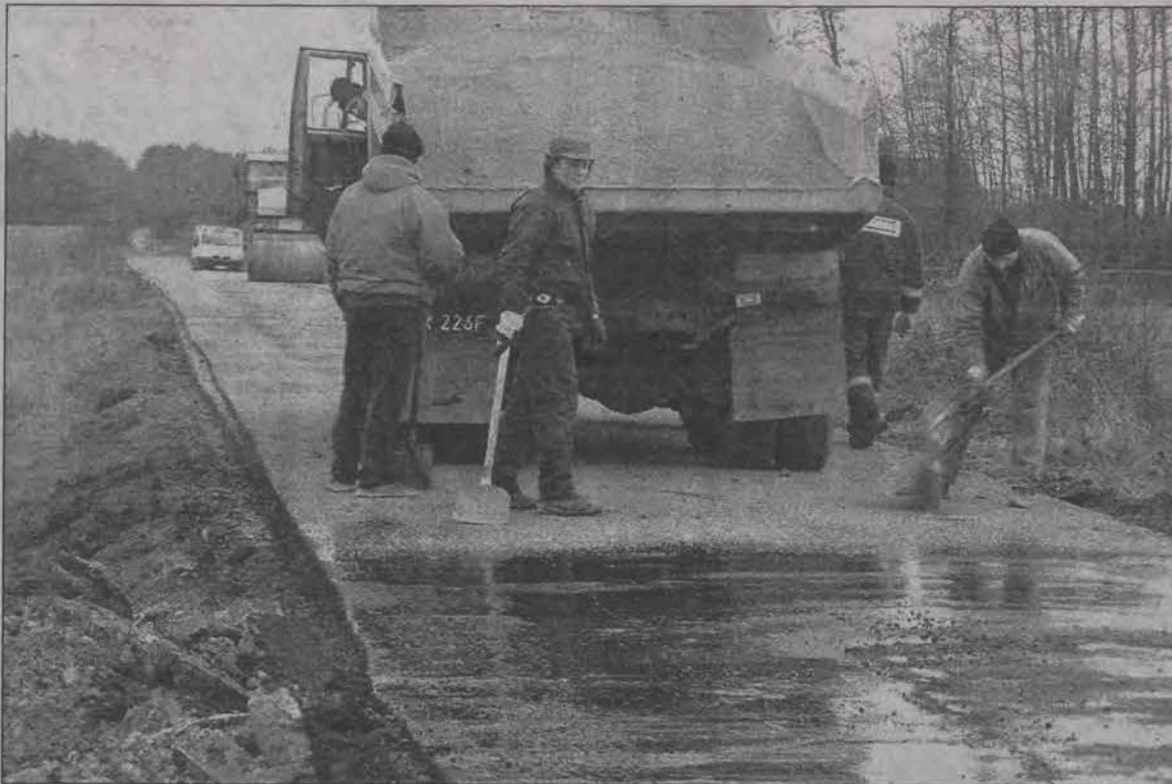
DROGĘ DOKOŃCZĄ NA WIOSNĘ. W przyszłym roku na wiosnę ma zostać całkowicie zakończona budowa ponad-dwukilometrowej drogi asfaltowej z Łyszkowic Kolonii do Kalenic. Ostatnie prace przed zimą firma Trabag z Warszawy prowadziła na początku grudnia. W przyszłym roku ma zostać położona jeszcze jedna warstwa ścieralna asfaltu oraz poprawione zostaną pobocza drogi. Inwestycja kosztowała gminę około 500 tysięcy złotych. W zamian za nienaliczanie kar umownych, firma wykonać ma nieodpłatnie odcinek drogi w pobliżu kościoła w Stachlewie. (mak)
