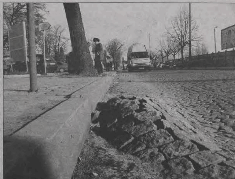
Garb wyrósł na ul. 3 Maja. Na wysokości budynku starostwa na ul. 3 Maja w Łowiczu, przy krawężniku, już od jakiegoś czasu wyrósł garb z bruku. Główną przyczyną spiętrzenia bruku są wjeżdżające tu samochody ciężarowe z dużymi ładunkami. Jeżeli tylko nie będzie padało zbyt obficie to ZUK wyrówna nawierzchnię ulicy 3 Maja. (eb)
