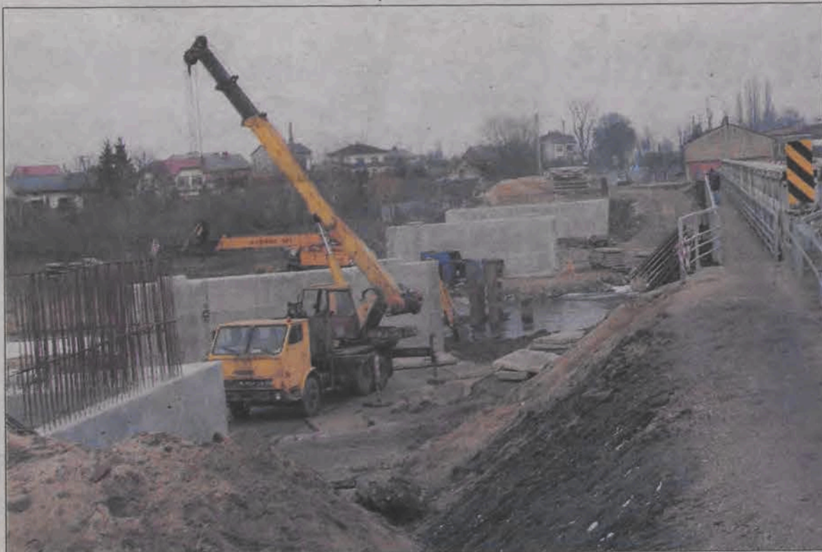
MOST PNIE SIĘ W GÓRĘ. Prace przy modernizacji mostu warszawskiego w Łowiczu prowadzone są z niewielkimi przerwami przez całą zimę. Dodatnia temperatura utrzymująca się w większości w tym okresie pozwala na szybkie postępy prac. Przebiegają one zgodnie z planem. Most pnie się już w górę. Obecnie budowane są betonowe elementy mostu - podpory i przyczółki. Przypomnijmy, że stary most został zburzony 13 października. (eb)
