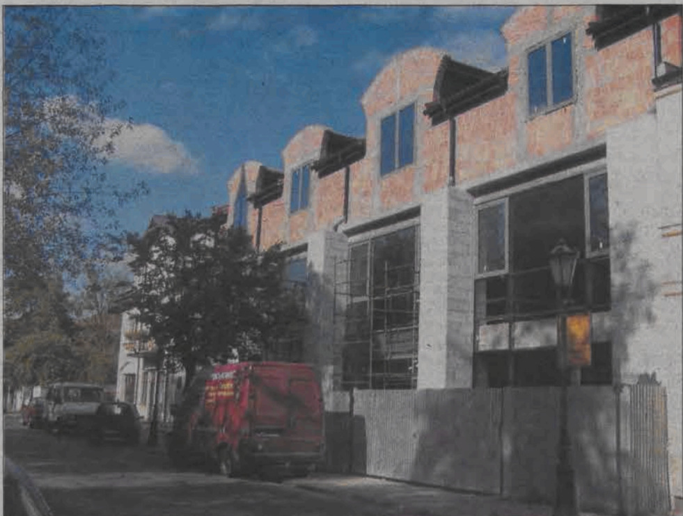
W ubiegłym tygodniu montowane były okna w Galerii Łowickiej od strony ul. Długiej. Fasada od strony ul. Stanisławskiego została w nie wyposażona wcześniej.
