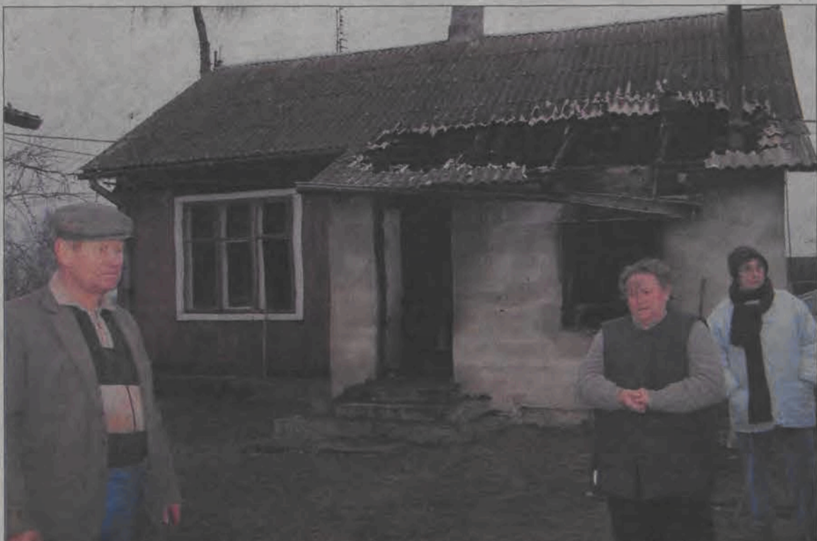
Stanisław Wiechno (pierwszy z lewej) oraz jego żona Elżbieta załamują ręce. Drewniany dom jest doszczętnie zniszczony od wewnątrz - nadaje się tylko do rozbiórki.
