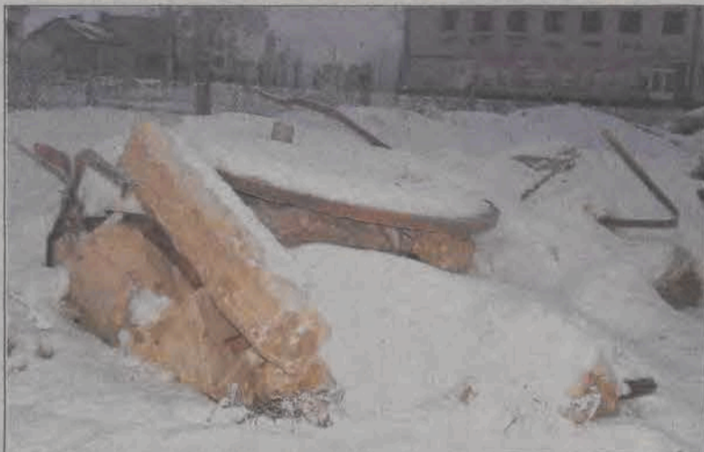
Elementy betonowe i stalowe przy basenie przeciwpożarowym w Kiernożi przygotowano pod kątem planowanego zasypiania go. Ich widok kłóci się jednak z przyjętym właśnie regulaminem.
