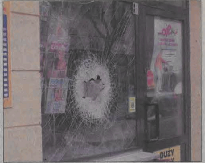
Szyba nie rozsypała się w drobny mak, ale otwór umożliwił kradzież dwóch telefonów.
