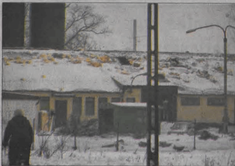
Śnieg przykrył częściowo zniszczony przez płomienie dach hali suszarni młyna na Nadburzańskiej.
