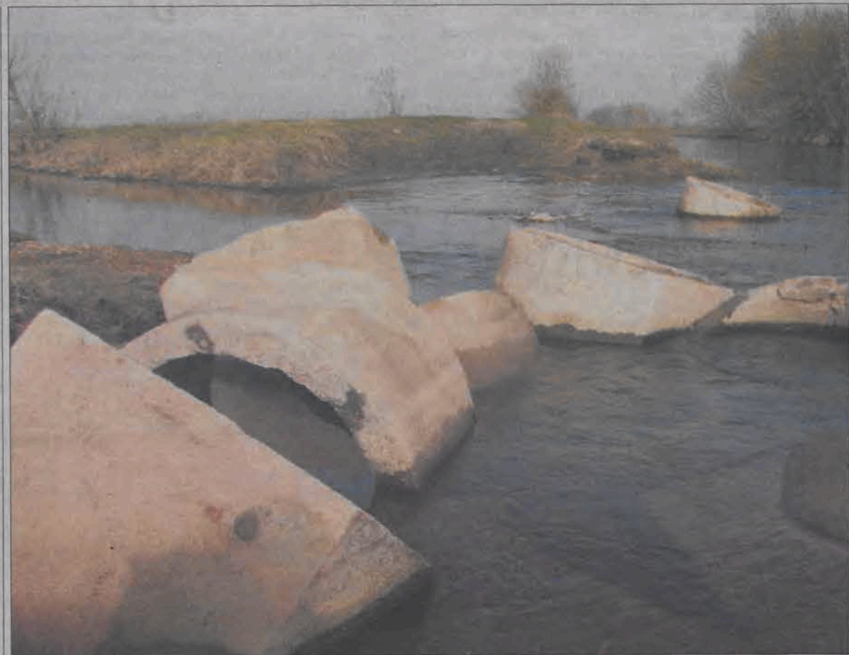
Wyjątkowo wysoka woda u schyłku tej zimy sprawiła, że ciężkie kręgi betonowe, przez które wody Otolanki wpływały do Bzury zostały przesunięte a ziemia rozmyta szerzej niż kiedykolwiek w ostatnich latach. Popularne spacery z Łowicza wzdłuż rzeki muszą się na razie kończyć w tym miejscu.
