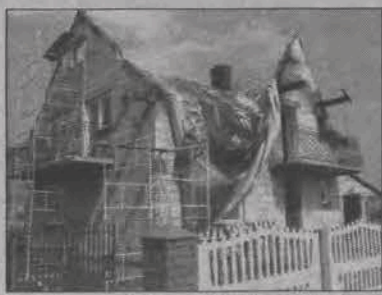
Spalone piętro nakryte jest plancką, aby chronić dom przed zimą i wilgocią, dopóki nie zostanie odbudowany
