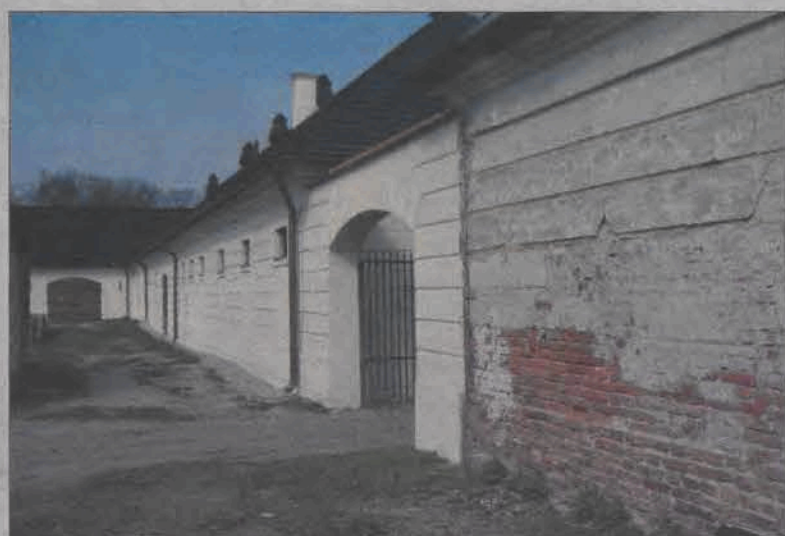
Ściana odnowionej stajni mocno kontrastuje z odrapaną częścią wozowni.
