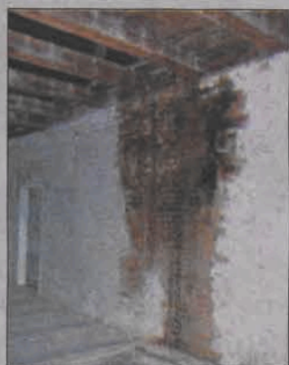
Zacieki, wilgoć - po skuciu tynków widać, że ściany są w złej kondycji.
