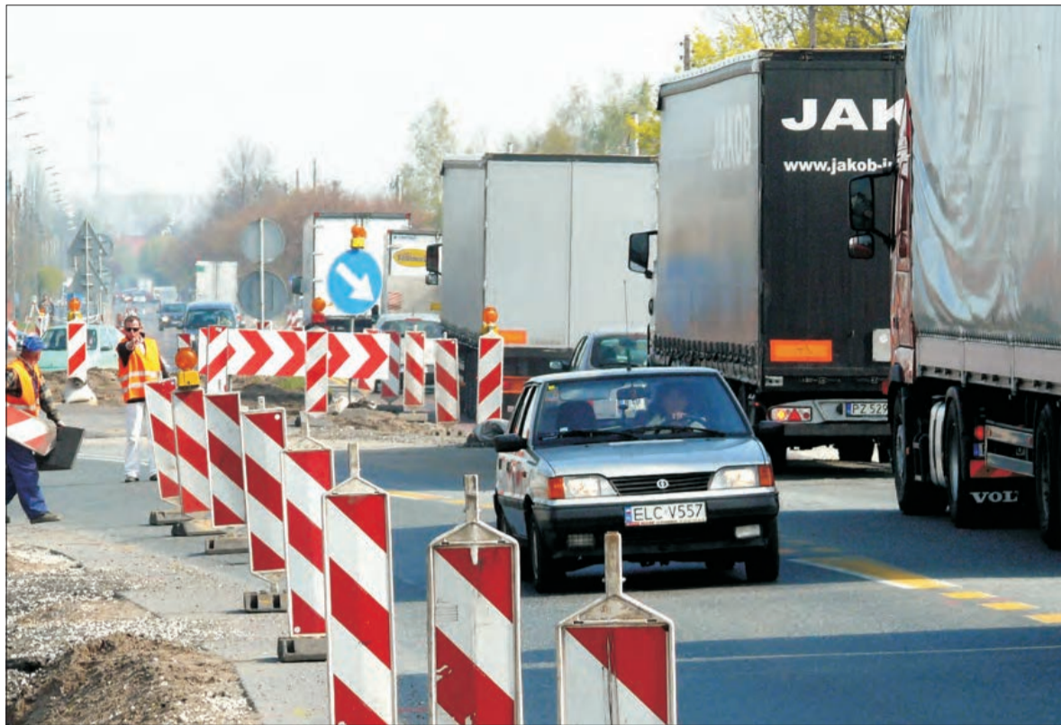
Ciągle korki na wylocie z miasta. Prace przy budowie ronda u zbiegu ul. Łódzkiej i Prymasowskiej w Łowiczu są powodem tworzenia się korków. Kolejna fala szczególnie uciążliwych prac ma się zacząć 5 maja. Jadąc do Łodzi, warto kierować się objazdami przez Pilaszków bądź wręcz przez Chruslin.
