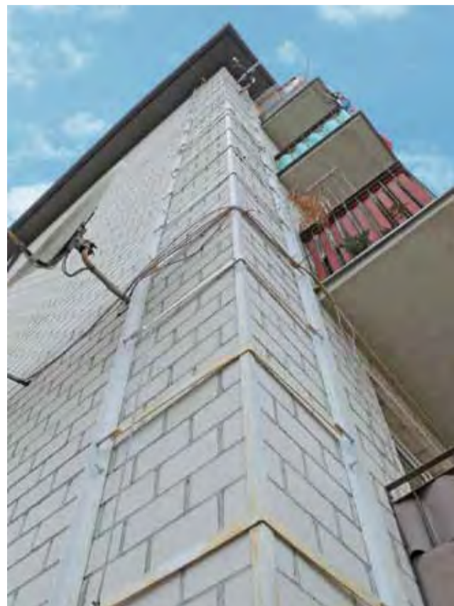
Stalowa drabinka w narożniku bloku 430 przy ulicy Armii Krajowej została zamontowana, by utrzymać cegły na swoim miejscu.
