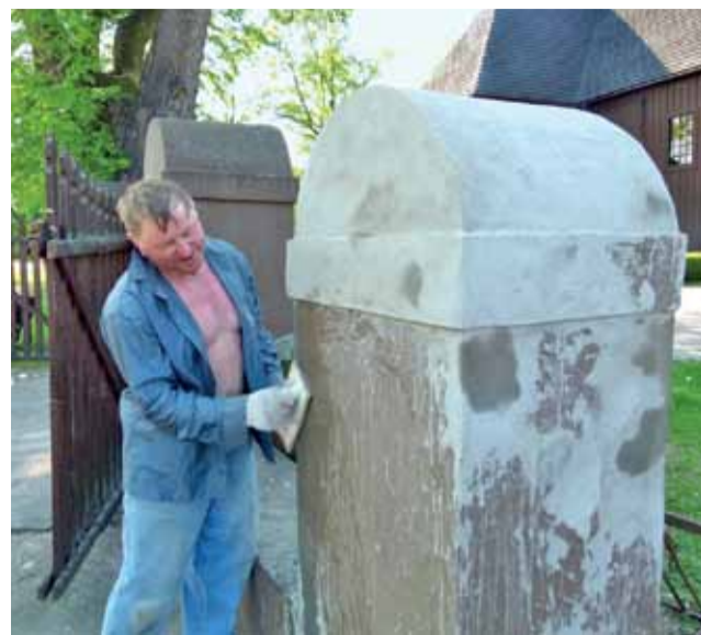
Betonowe słupki zostaną pomalowane, a między nimi zamontowane zostaną drewniane przęsła. Remont ogrodzenia przy kościele pw. Narodzenia Najświętszej Marii Panny w Starym Waliszewie w gminie Bielawy przeprowadza Józef Wojcieszek z Dąbrowy koło Głowna. td
