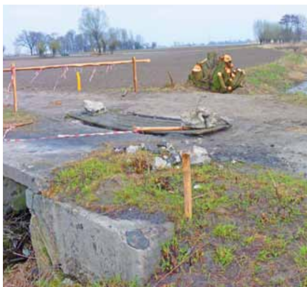
Przepust został naderwany już na początku kwietnia.
